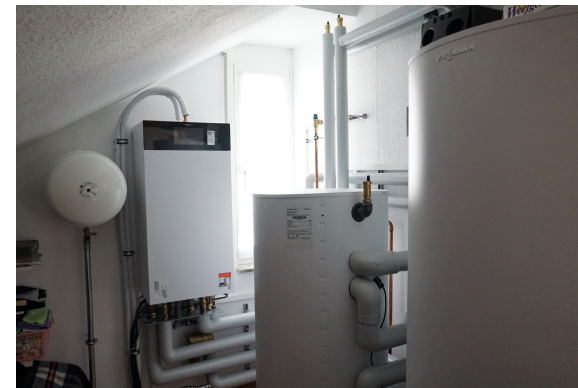
Innenanlage Wärmepumpe, Warmwasserspeicher, Pufferspeicher
