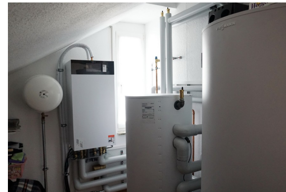
Innenanlage Wärmepumpe, Warmwasserspeicher, Pufferspeicher
