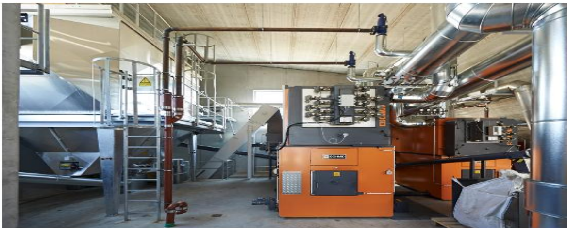
Blick in das Innere der Anlage mit den zusätzlichen Holzverbrennungsöfen, links die Filteranlagen Quelle eba.
