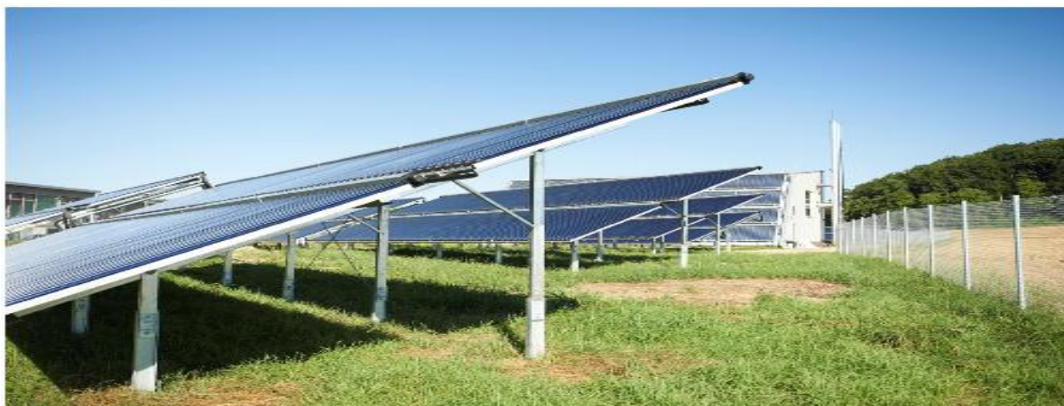
Blick auf das Kollektorfeld der Solarthermie-Anlage Büsingen (Vakuurröhren), Quelle Solarkomplex
